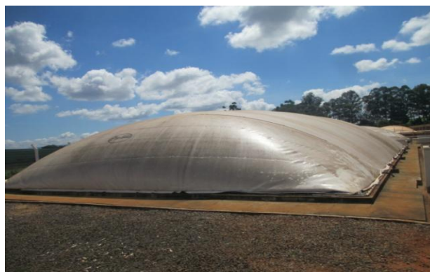
Figura 1 - Biodigestores Anaeróbicos. Fonte própria
