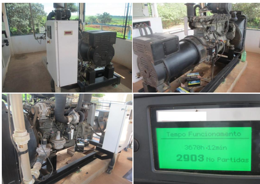
Figura 5 - Grupo gerador a Biogás. Fonte própria
