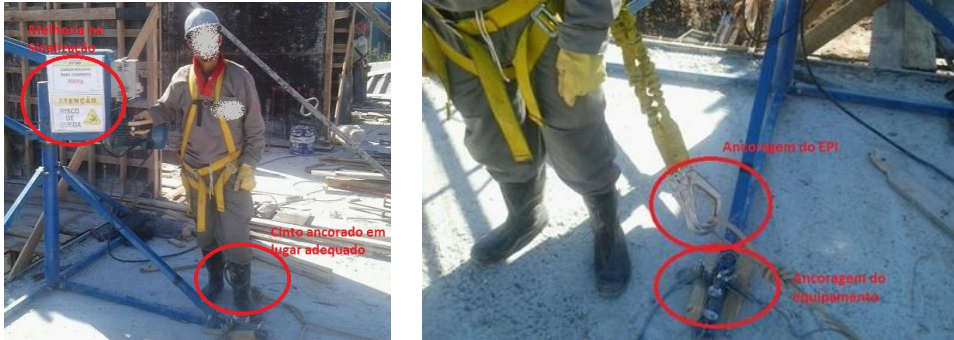
Figura 3: Melhorias na sinalização de alerta de risco e de procedimentos adequados de ancoragem de cinto de segurança
