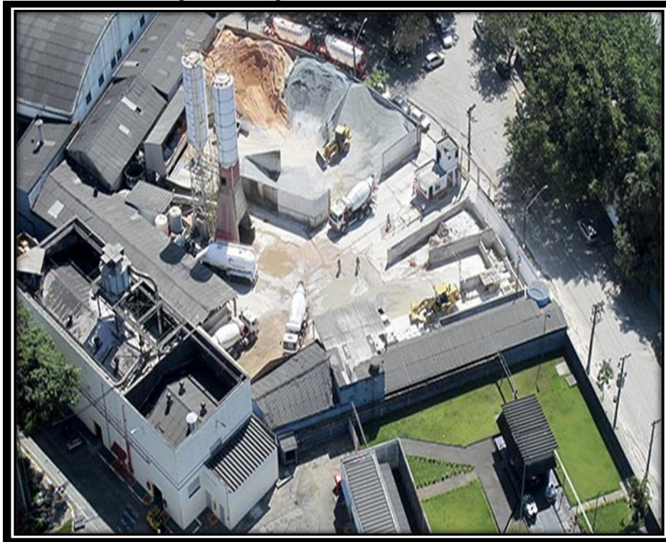
Figura 3 – Imagem Aérea da Usina de Concreto
