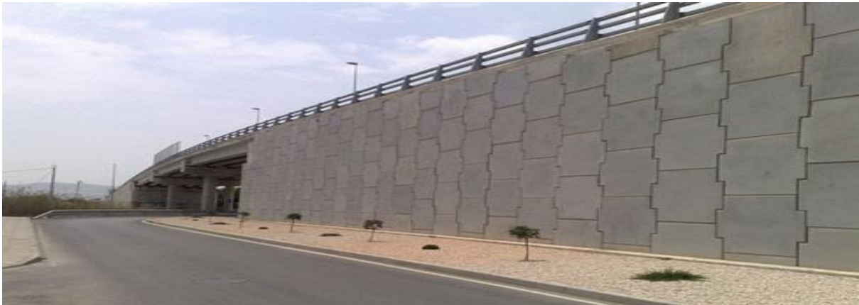
Figura 03: Muro de contenção em terra armada.
