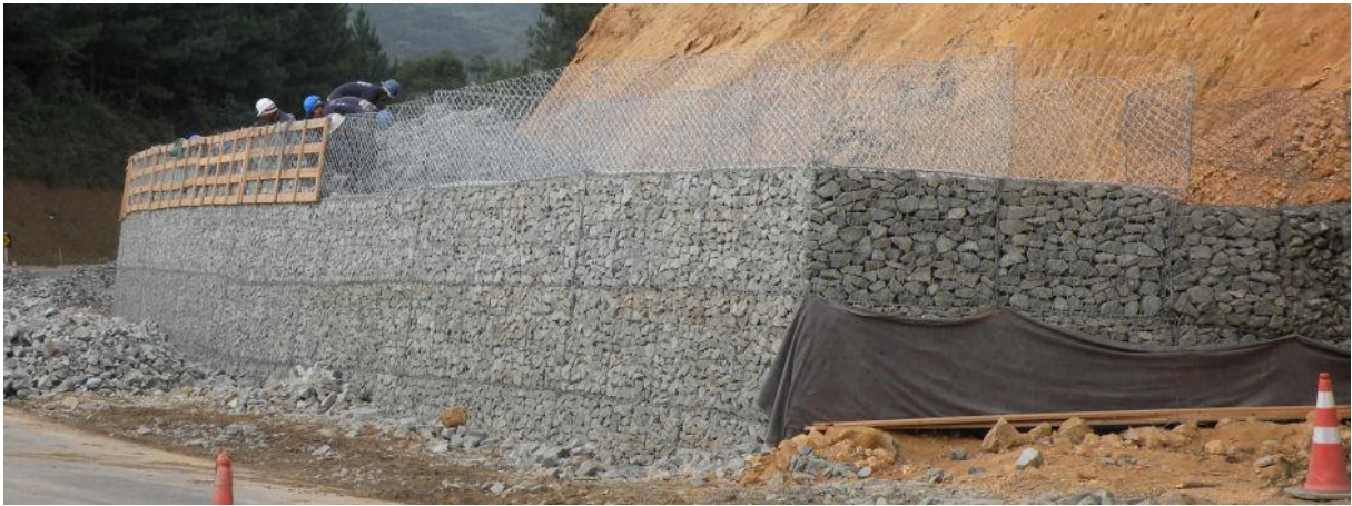
Figura 04: Muro de contenção em terra armada.
